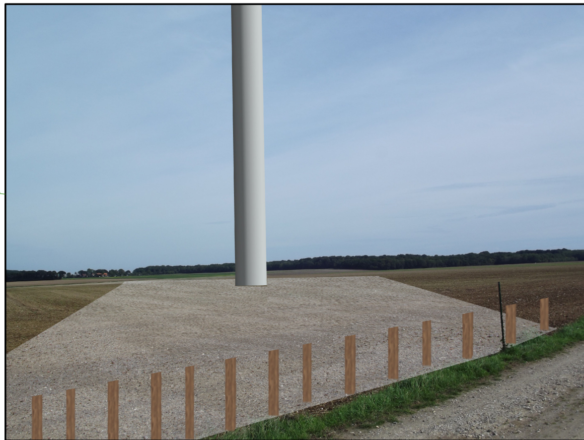
Après l'implantation de l'éolienne
